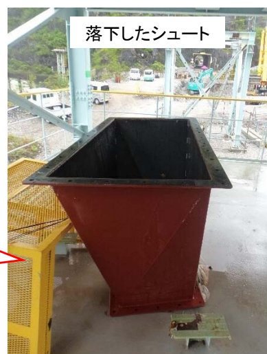
損傷した ベルトカバー
